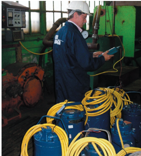
Odbiór urządzenia po remoncie – przenośnych pomp zatapialnych – realizowany w III etapie nadzoru eksperckiego nad remontami maszyn i urządzeń górniczych.
